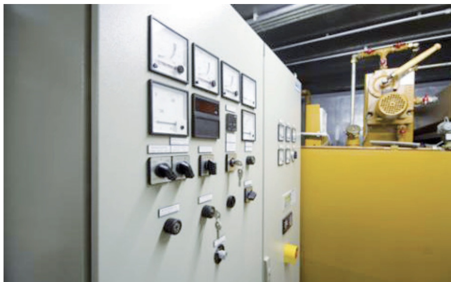
Diesel-Aggregate für längeren Stromausfall
